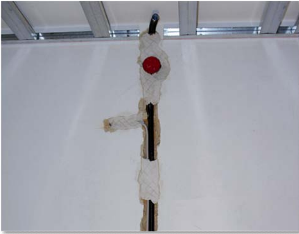
Elektrische Zuleitung Electrical power supply
