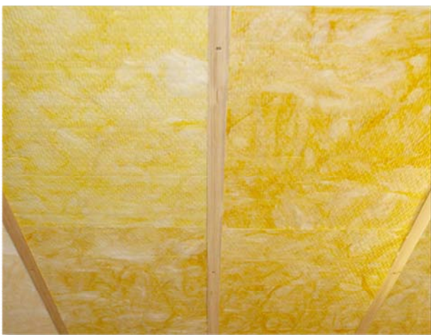
Holzkonstruktion, Isolierung flächenbündig mit der Lattung Substructure made of wood. Insulation must be flush with the lower edge of the substructure
