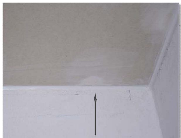
Achtung! An den Umfassungswänden Dehnungsfugen bilden und mit Acryl ausspritzen Important! Please form expansion joints at the ceiling attachments of the enclosure walls by filling it with acrylic
